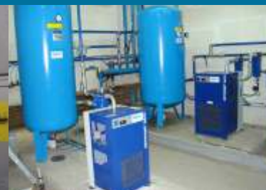
Manutenção ar comprimido
